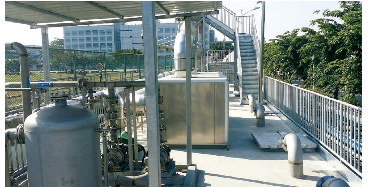
食堂污水站构筑
