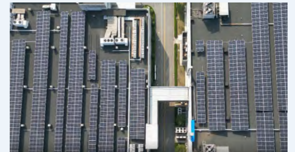
光伏发电项目
