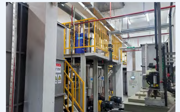
废水预处理设施
