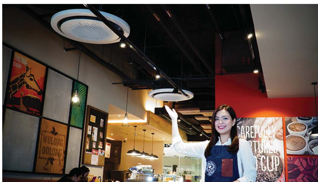
Кассетный кондиционер 360 установлен в 18 кафе сети Coffee Bean
